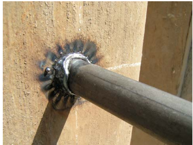
Abbildungen 6 und 7: Kopfbolzen 19 mm Durchmesser, geschweißt an einer Spundwand in Position PC
