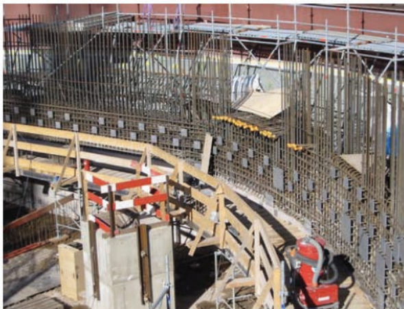
Bild 15: Ankerplatten in einem Kernkraftwerk
